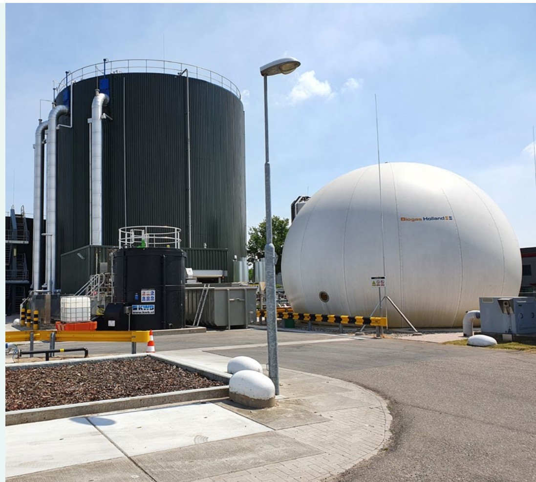
13 Slibgisting en biogasinstallatie op RWZI Tiel
